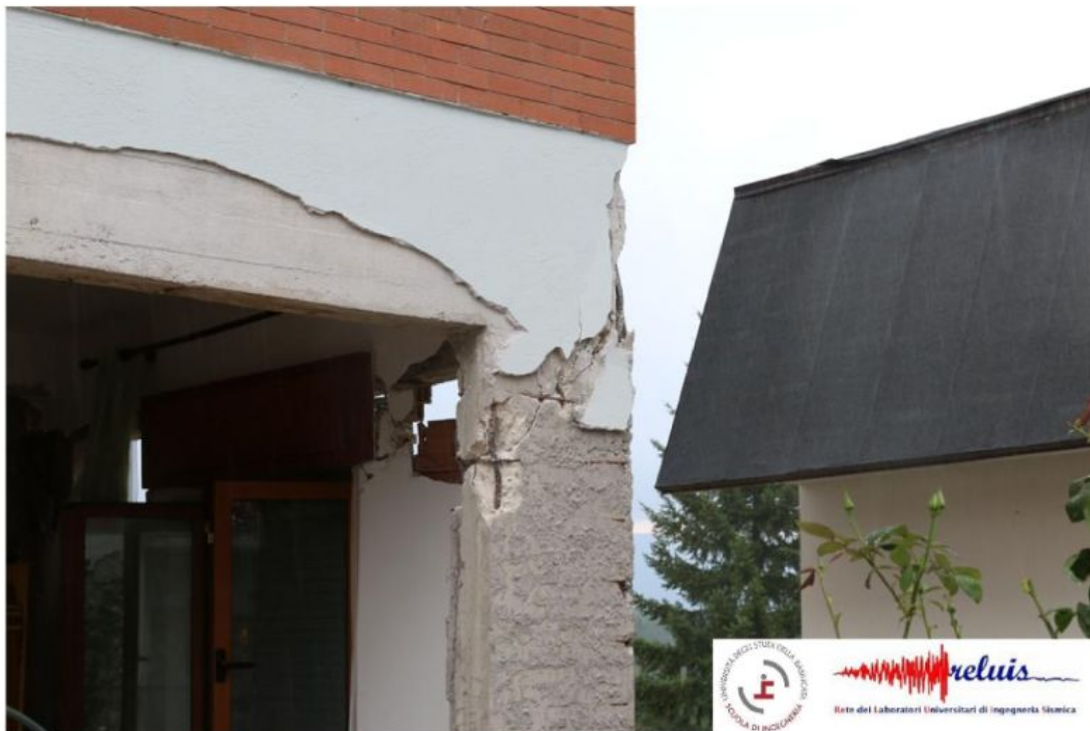
Particolare del danno ad un nodo trave-pilastro
