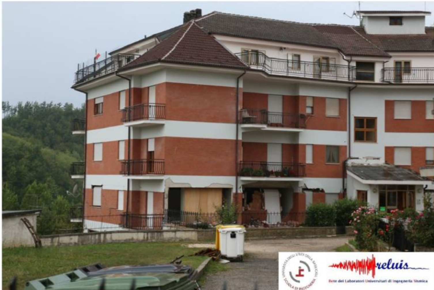
Danno alle tamponature
