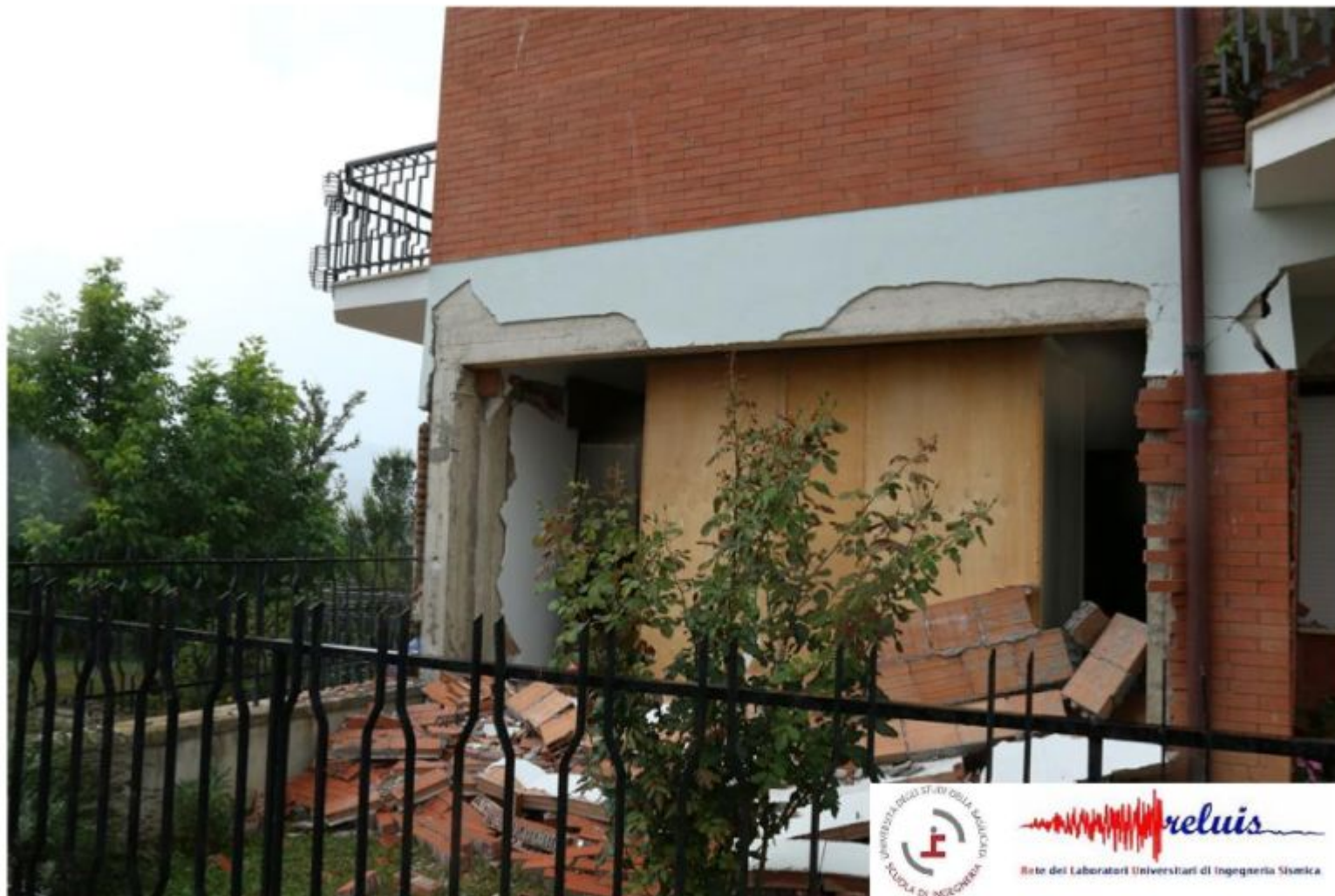
Danno alle tamponature
